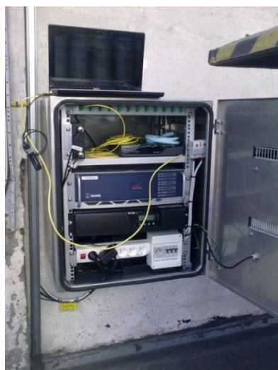
Rysunek 15 Widok otwartej szafy stacji bazowej na Elewatorze Ewa.
