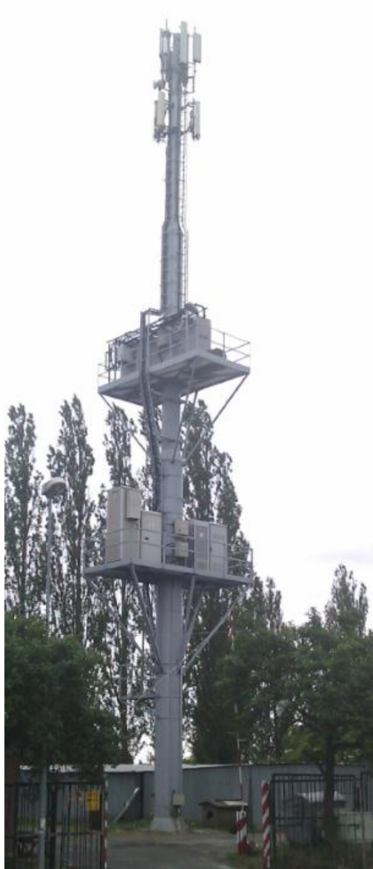
Rysunek 53 Przykładowa platforma z pomostami na szafy IT Źródło: Opracowanie własne
